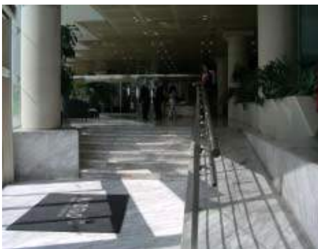
Ejemplo de rampa con pavimento deslizante y no señalizada en el área de embarque y desembarque
