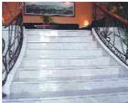
Como ejemplo de buena práctica en accesibilidad esta escalera dispone de zócalo lateral de protección y pasamanos a ambos lados, además de tabica. Debería incluirse una banda antideslizante en el borde de cada huella ya que se ha utilizado para los peldaños un pavimento demasiado pulido y deslizante
