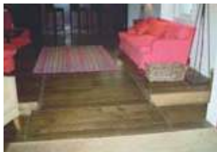
Vestíbulo de Acceso a restaurante mediante rampa de suave pendiente que salva un escalón. La moqueta situada en el rellano superior de la rampa no está anclada al suelo y puede ser un obstáculo para el rodamiento de la silla de ruedas
