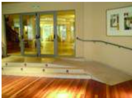
Acceso al restaurante salvado mediante rampa y escalera. A ambos lados de la rampa debería existir un doble pasamanos
