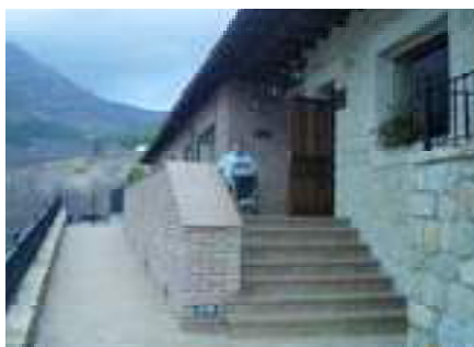
Escalera sin pasamanos laterales de sujeción
